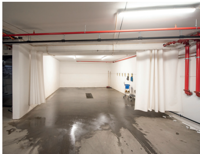
Felles vaskehall for bil har allerede blitt godt brukt av de nyinnflyttede beboerne.
